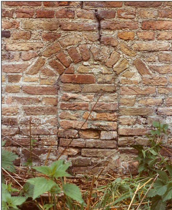
Hierboven is een detailopname (foto EV 2787A) van het dichtgemaakte "oude" kelderraam in de noordelijke zijgevel van Grinsel 69. Er bevond zich een mooie, dubbele ontlastingsboog boven.
