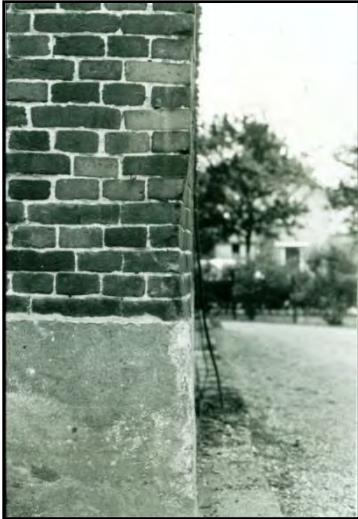
Door het slijpen van messen ontstond de uitholling aan deze noordhoek. Foto EV 1553, uit 1984.
