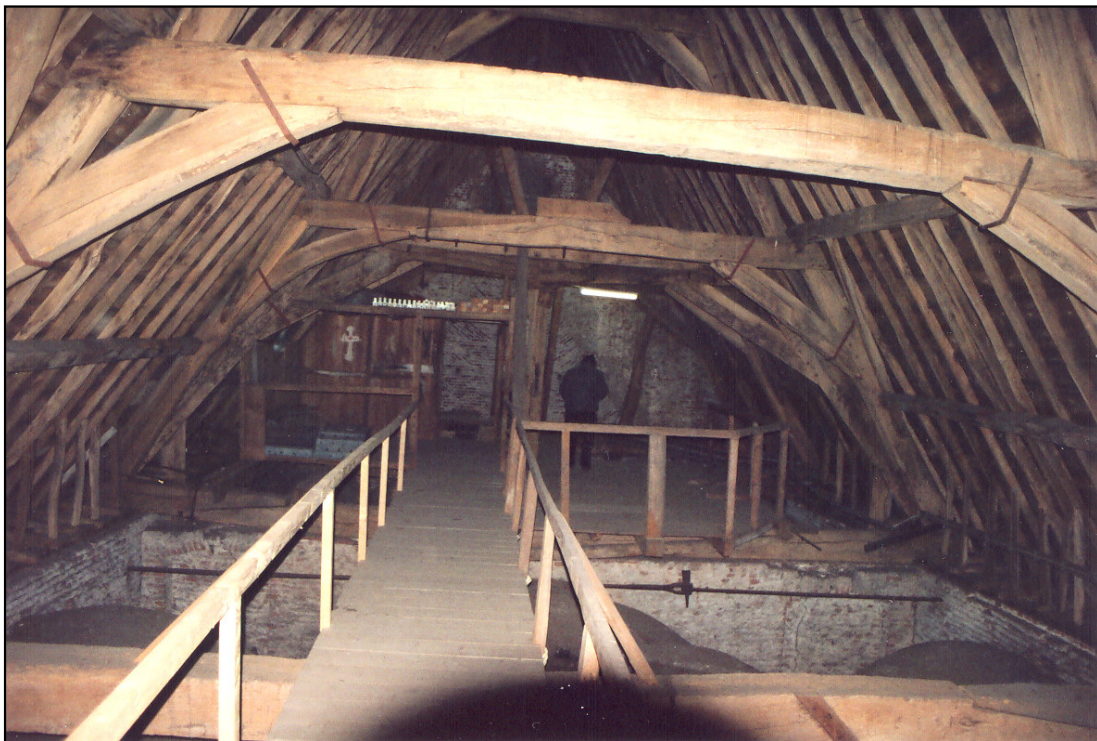
De kapconstructie van het schip gezien vanuit het westen. Links achter de (18 e -eeuwse?) behuizing van het horloge. Daarnaast de stijl die de grote toren op het schip droeg. Daarachter de gevel van het koor.
