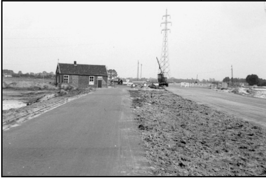
Aanleg van de nog bredere weg. De Anjabar is er nog. Foto uit 1966/1967.
