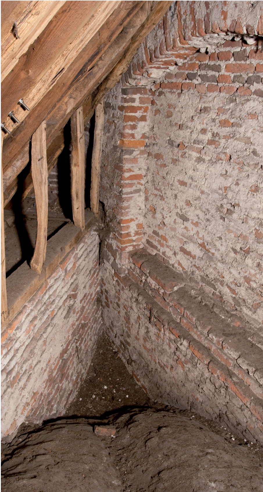
Afbeelding 14: In de zuidbeuk sluit het muurwerk van de zijbeuk koud aan op de muur van de lichtbeuk. Op de foto een laag spaarveld, dat laat zien dat van meet af aan rekening werd gehouden met de afschuining van de zijbeuk. Een dergelijke afschuining, niet erg gebruikelijk, komt ook voor in Rosmalen waar de afschuiningen echter de toren insluiten.
