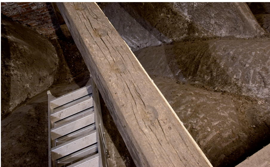
Afbeelding 30: De vier eigenaardige, conische inkepingen in de onderslagbalk van het derde spant.
