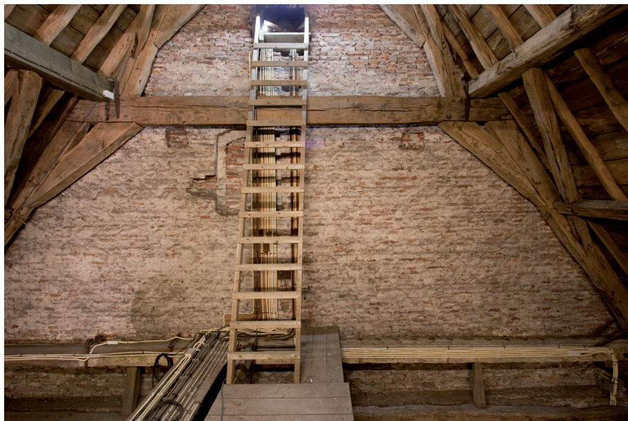
Afbeelding 12: De muur tussen het koor en het schip, gezien vanuit het koor. Onder de huidige, toegevoegde doorgang, een dichtgezette opening welke vermoedelijk van oudsher de toegang tot de koorkap vormde.
