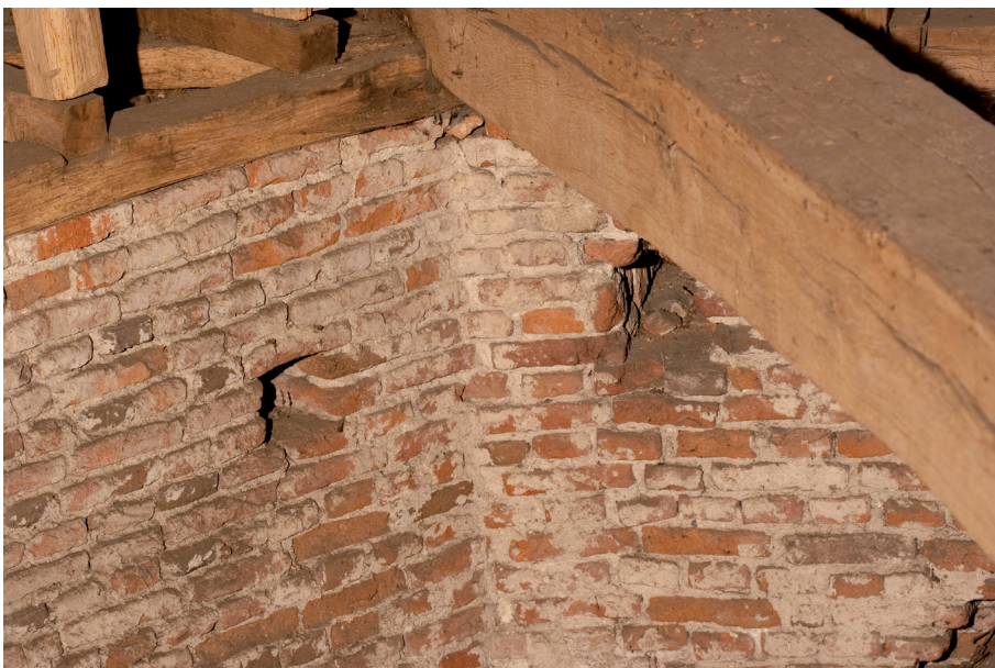
Afbeelding 17h: Niet of nauwelijks zichtbaar is de staande tand ter plaatse van het rechter kortelinggat. Dit duidt erop dat er een faseverschil bestaat tussen de zuidgevel van het koor en de noordgevel, welke zeer waarschijnlijk later is.
