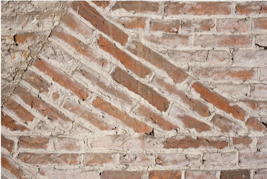
Afbeelding 12a: Een detail van één van de vlechtingen in de muur tussen koor en schip, hier de schipzijde. Het muurwerk is netjes gevoegd, een aantal stenen lijkt een geschuurd oppervlak te hebben.
