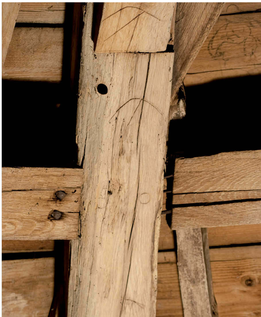
Afbeelding 30c: Het noordelijke van de twee halve spanten in de koorsluiting heeft ter plaatse van de aansluiting van de onderste gordingen twee gestanste rondjes, wat er op wijst dat de werkplaats waar de constructie werd gemaakt, er in eerste instantie vanuit ging dat de verbinding tussen spantbeen en gording zou worden gepend en met toognagels gezekeerd. Daarboven telmerken en een gat gemaakt door de holle boor waarmee dendromonsters zijn genomen.
