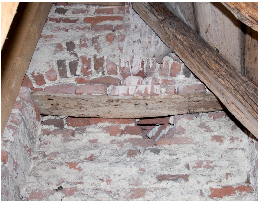
Afbeelding 17c: Ter plaatse van de deur van de traptoren naar de kap van de zuidelijke zijbeuk is nog te zien op welke wijze men in de zestiende eeuw de boog van het spaarveld heeft gemetseld. Hier is het formeel nog in situ aanwezig.
