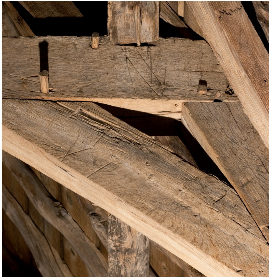
Afbeelding 32: Twee merken op één van de spanten in het schip die vermoedelijk als handelsmerken te duiden zijn. De kapconstructie staat er vol mee.
