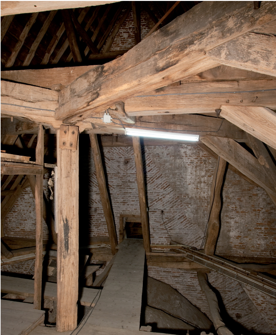
Afbeelding 35: De middenas van de constructie waarop oorspronkelijk de vieringtoren heeft gestaan. Met name de dekbalken verkeren in zeer slechte staat als gevolg van jarenlange inwatering.
