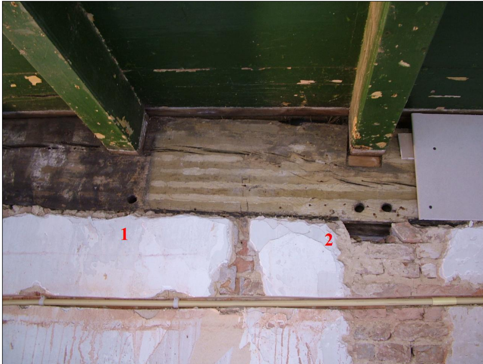
Figuur 22. De moerbalk van gebont I gezien vanaf de voorkant. Het gat bij 1 markeert het linkse uiteinde van de grote hoekgevel; links daarvan was binnen, rechts daarvan buiten. Let op de verfresten rechts van dit pengat. De uitgekapte holte waarin de deurstijl stond (bij 2) staat rechtop (niet schuin zoals bij een schoor), aan deze zijde van de balk, zodanig dat de voorkant van de dunnere deurstijl gelijk kwam met het gebont. De deurstijl werd geborgd met 2 pennen. De zolderbalken in de uitkamer (links) passen in uitsparingen van de moerbalk (dus zijn authentiek?). In de voormalige hoekruimte voor de deur zijn de balken net zo hoog, maar de uitsparingen in de moerbalk zijn verder uitgekapt en moesten worden opgehoogd bij de aanleg in 1859 van de kamer waarin deze foto werd gemaakt.
